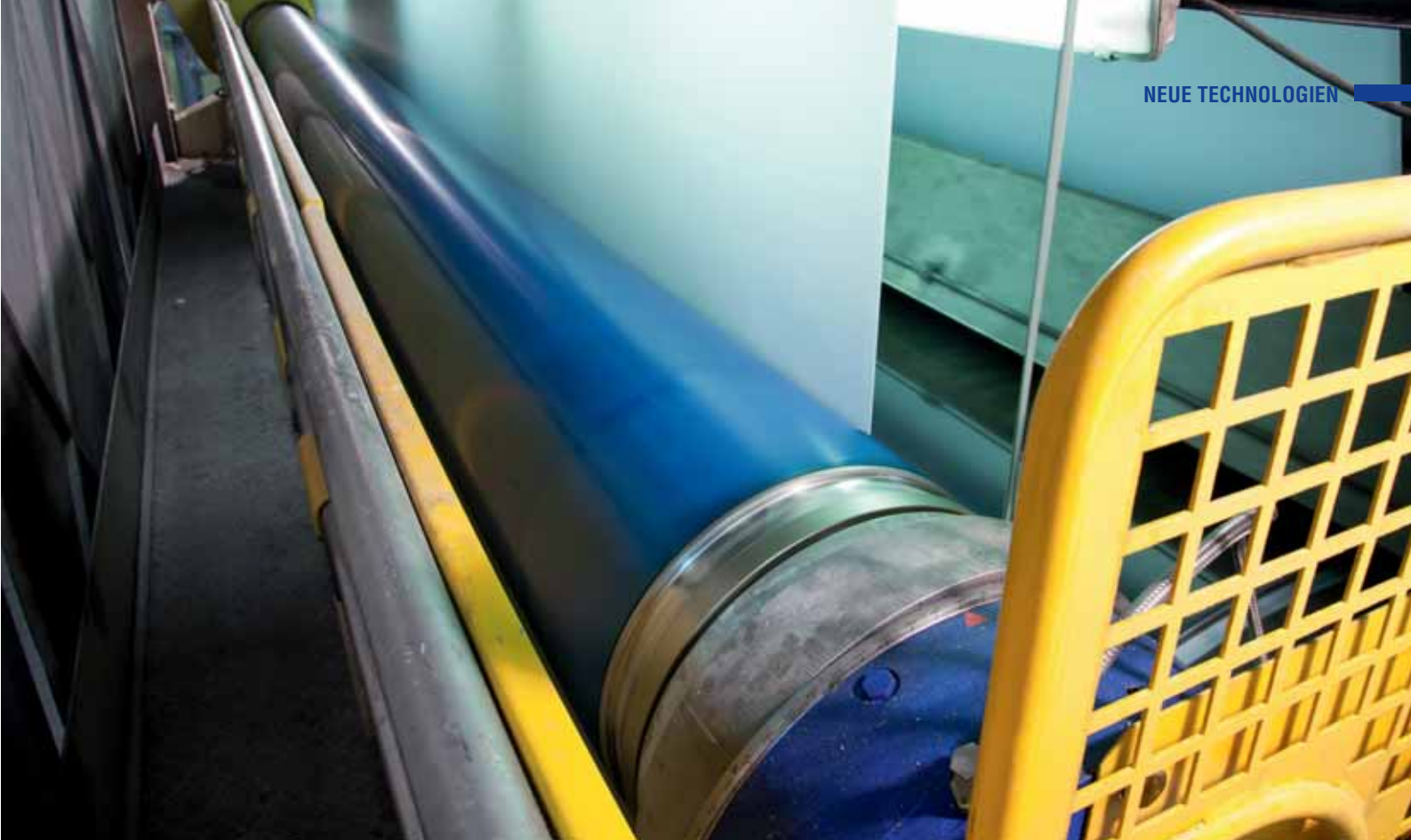
Abb. 2: Die zweite CarboStretch bei Sappi Gratkorn, installiert in der SM 9, läuft seit der Inbetriebnahme einwandfrei.
