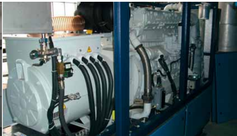
Abb. 2 und 3: Fast 500 MWh Strom produziert das Blockheizkraftwerk im deutschen Düren pro Jahr (oben). Zudem wurde der Erdgasverbrauch durch besser isolierte Rohrleitungen gesenkt (unten).
